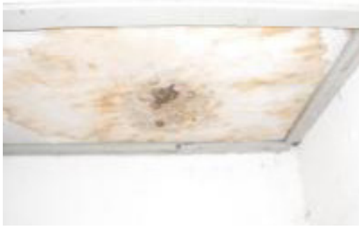
Fig. 5 Infiltração em Matharya
