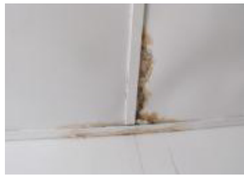
Fig. 2. Infiltração numa das Casas de Hóspedes
