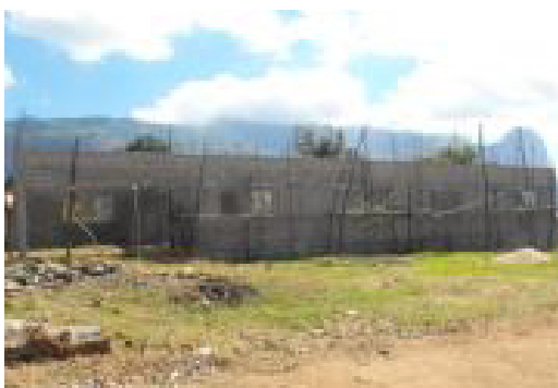
Fig. 3 Edifício de SDEJT 2 abandonado
