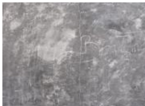
Fig. 12 Defeito no quadro preto
