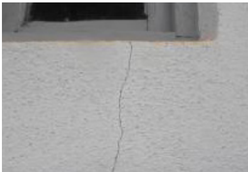
Fig. 7 Racha na parede de Matharya
