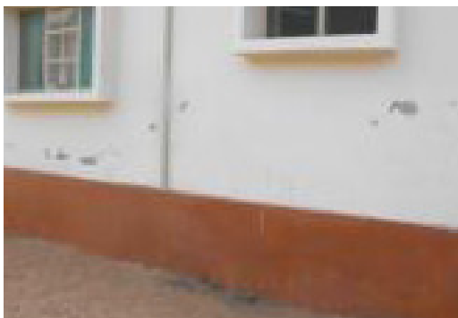
Fig. 1. Tinta descascada na Residência do SP
