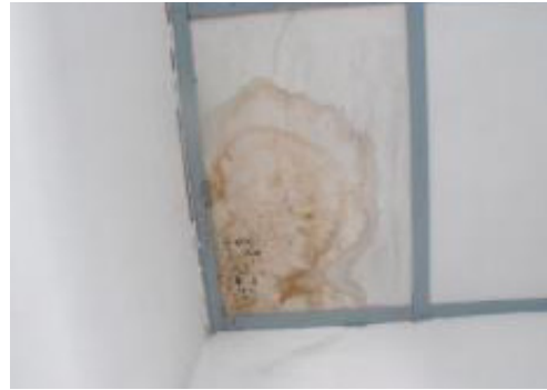
Fig. 6 Infiltração em lapala
