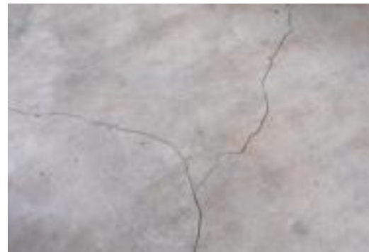
Fig. 8 Racha no soalho da Casa de Hóspedes
