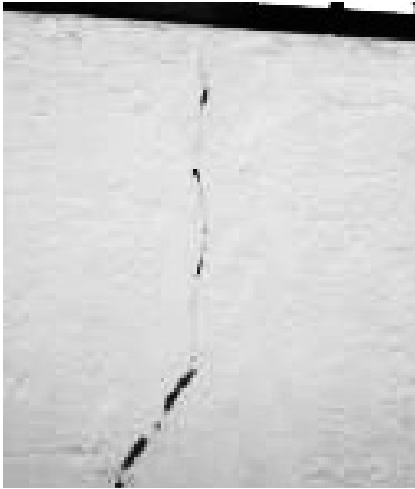
Fig. 5 Racha na parede do Mercado
