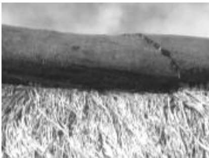
Fig. 1 Racha na cobertura do alpendre da ROA 1
