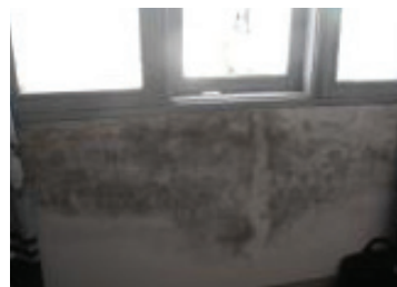
Fig. 9 Humidade na parede da casa do Director de SDAE
