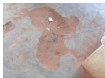
Defeito no soalho
