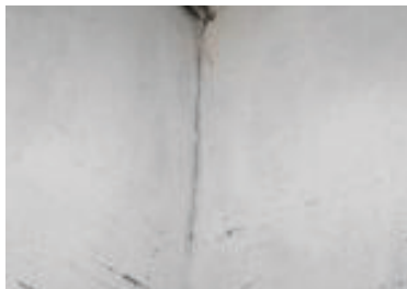
Fig. 3 Racha na parede da casa do régulo Cuizimba
