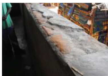
Parede a degradar-se
