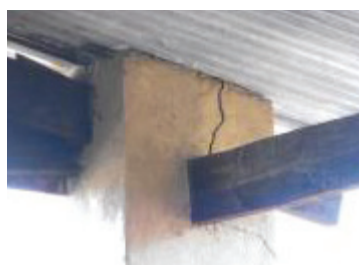
Racha na parede
