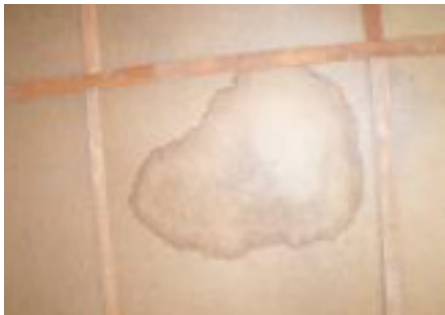
Fig. 4 Infiltração na Sede de Chihiri
