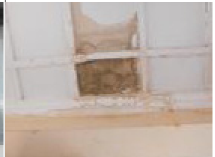
Fig. 6 Infiltração na casa do Chefe do P/A de Netia
