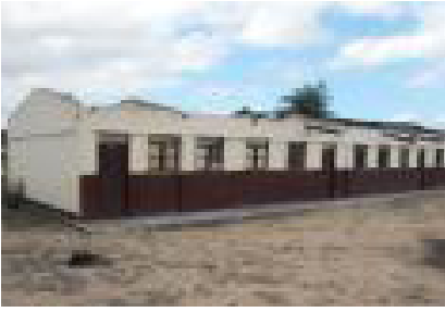
Fig. 16 Escola sem cobertura
