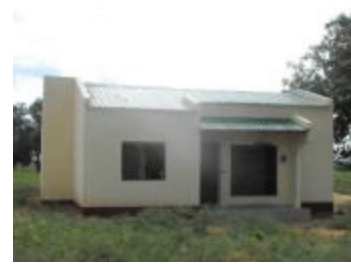
Fig. 7 Obra abandonada em Ntlavene
