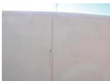
Fig. 9 Racha no muro da vedação
