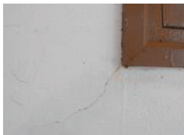
Fig. 5 Racha na parede de Combomune
