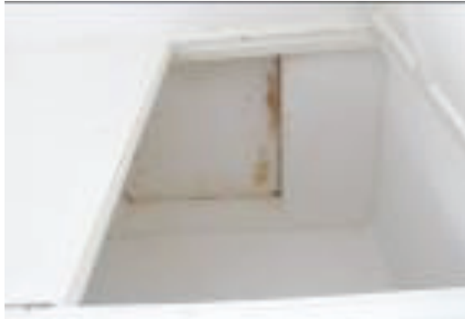
Fig. 1 Infiltração na Casa de Hóspedes
