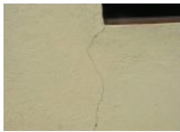
Fig. 6 Racha na parede de Ntlavene
