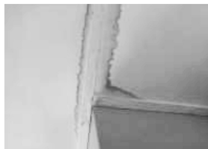
Fig. 2: Infiltração na residência oficial
