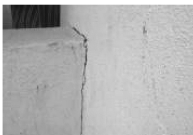
Fig. 5: Racha na parede
