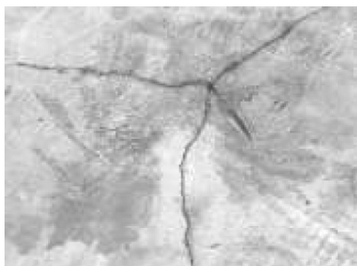
Fig. 7: Racha no pavimento da bomba
