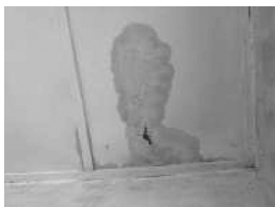
Fig. 3: Infiltração em Mitucue
