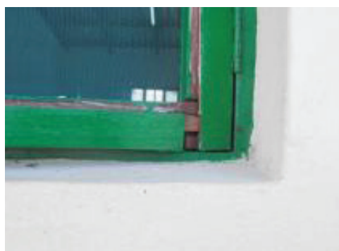
Fig. 9 Defeito no aro da janela de Lionde
