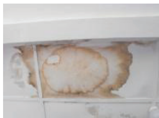
Fig. 3 Infiltração em Messano
